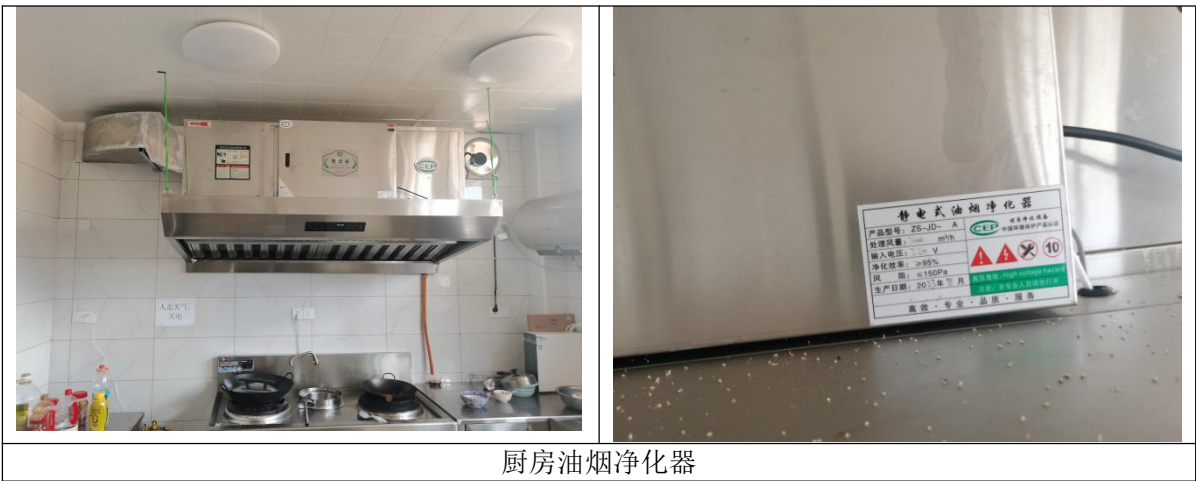
图 7.2-1 厨房油烟净化设备情况
