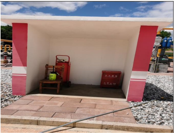
现场灭火设备
